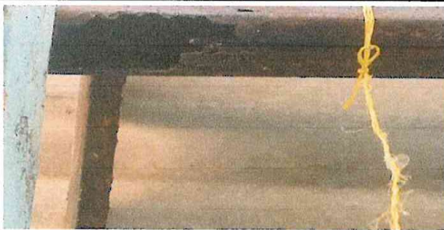
Foto 3: ESTRUCTURA METALICA DAÑADA POR EL OXIDO, SE MOJO A CAUSA DE LA DURALITAS QUE ESTA QUEBRADAS.
