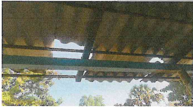
Foto 1: DURALITA DETERIORADA POR EL PASAR DEL TIEMPO DEJANDO AL DESCUBRIMIENTO LA ESTRUCTURA METALICA DE LOS SALONES DE CLASES DE LA ESCUELA.
